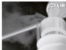
SF 6 gaz kaçağı
